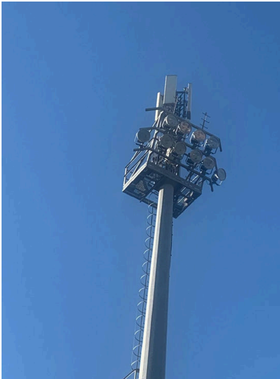
Fig.22: Struttura portante SRB e fari per illuminazione
