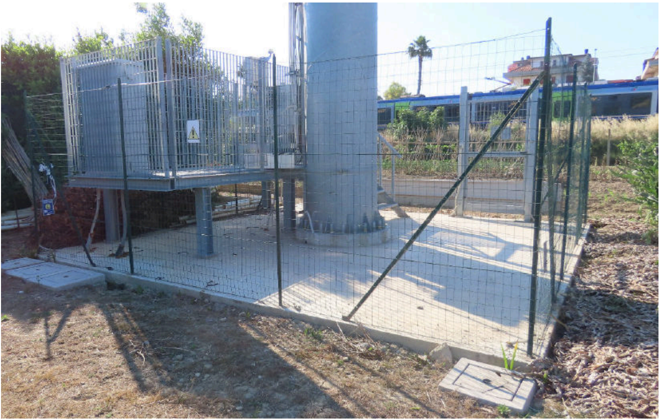
Fig.23: Struttura portante l'elettronica della SRB anti alluvione
